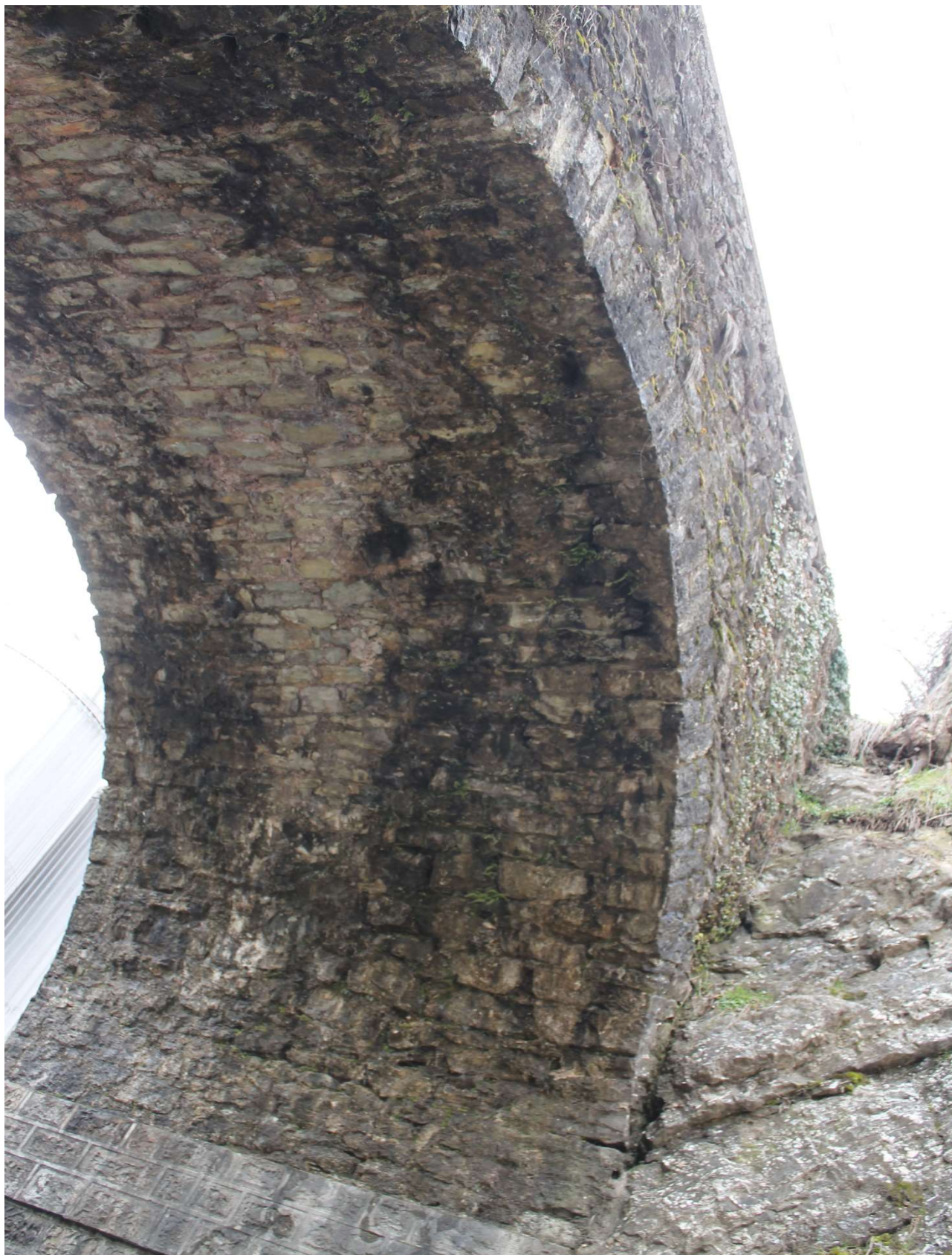
Foto 3 - Arcata Ovest, vista da sotto. La parte centrale, di colore chiaro, mostra la zona dove il percolamento è più accentuato.
