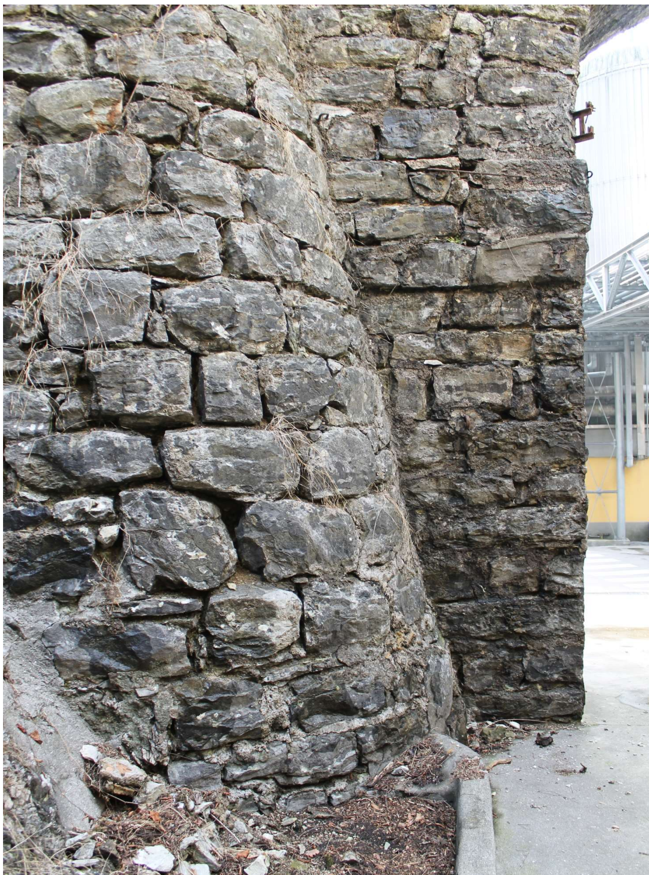
Foto 6 - Murature delle spalle, che hanno perso totalmente la malta delle connessioni.
