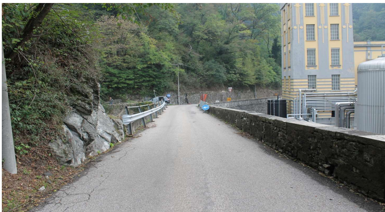
Foto 9 - Strada per Bregazzana, vista da monte. Si vedono le zone laterali da cui avvengono le principali infiltrazioni tra pavimentazione e parapetto e che vanno ad impregnare il sottostante manufatto.
