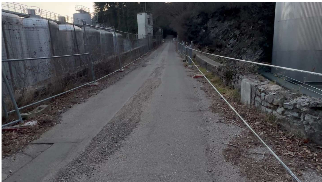
Foto 8 - Strada per Bregazzana, vista da valle, con i parapetti laterali di altezze non a norma ed in condizioni di degrado tali da farne temere il crollo.
