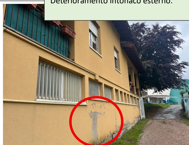
Deterioramento intonaco esterno.
