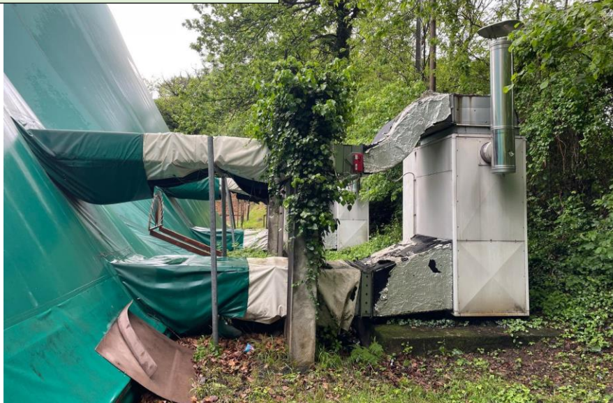
Impianto di ventilazione in stato pessimo.
