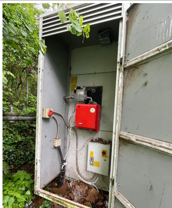
Impianto di ventilazione in stato pessimo.
