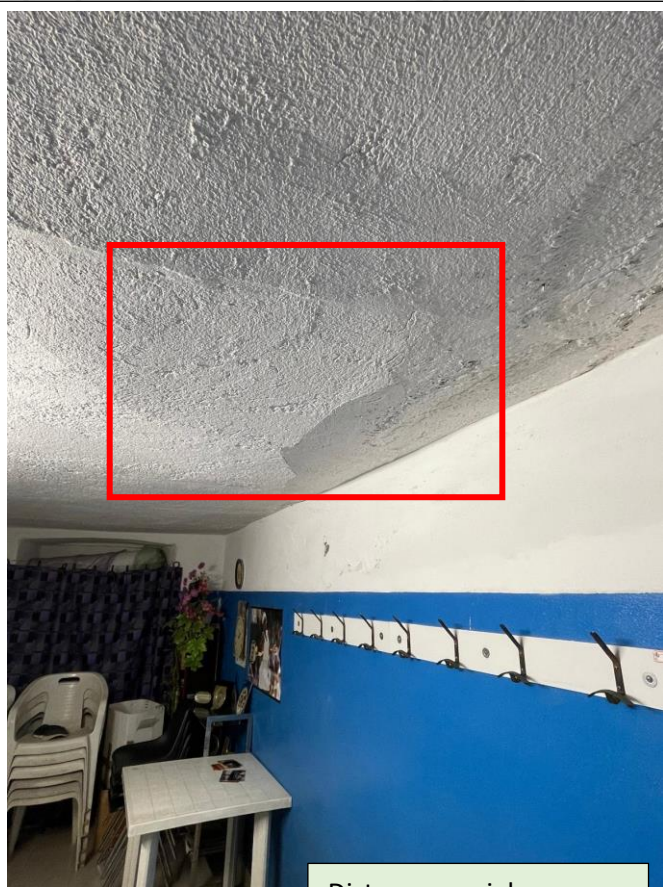
Distacco parziale intonaco a soffitto
