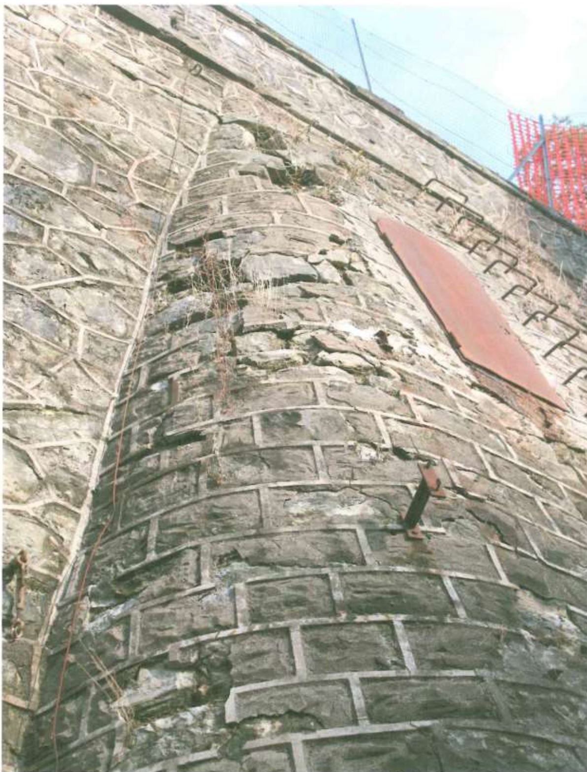
Foto 7 - Zona in cui il degrado, ha raggiunto proporzioni tali da esporre la muratura a rischi di crolli parziali.
