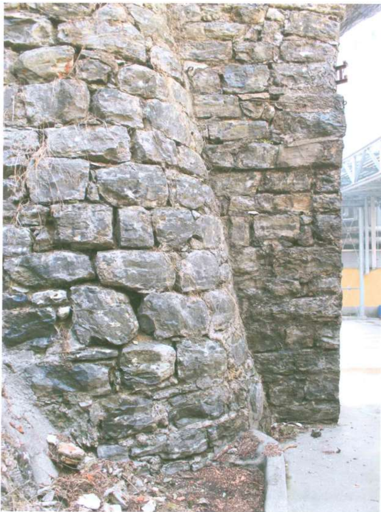
Foto 6 - Murature delle spalle, che hanno perso totalmente la malta delle connessure.
