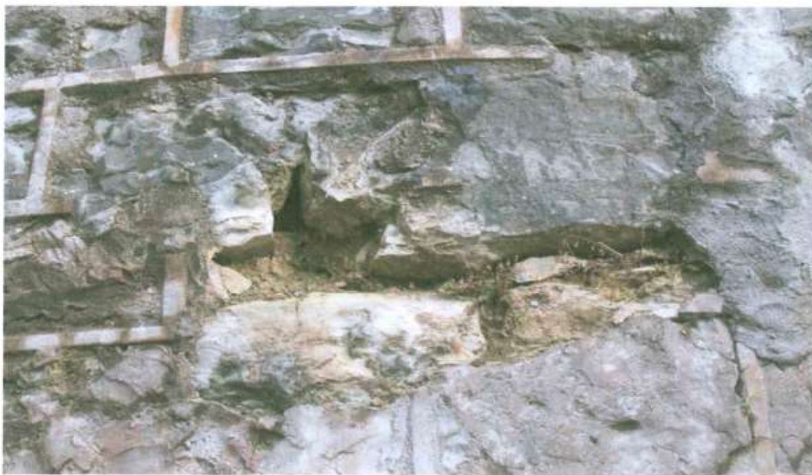
Foto 5 - Tipica azione geliva, che ha prodotto distacco e caduta di parte della muratura.
